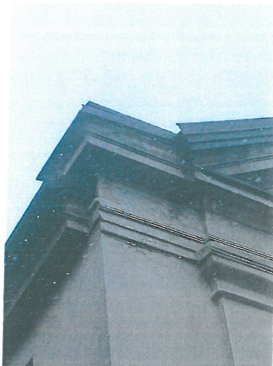
Zdjęcie 5 Uszkodzenia tynku w górnej części ryzalitu
