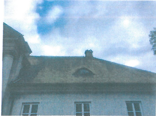
Zdjęcie 1 Stan pokrycia połaci północno-zachodniej
